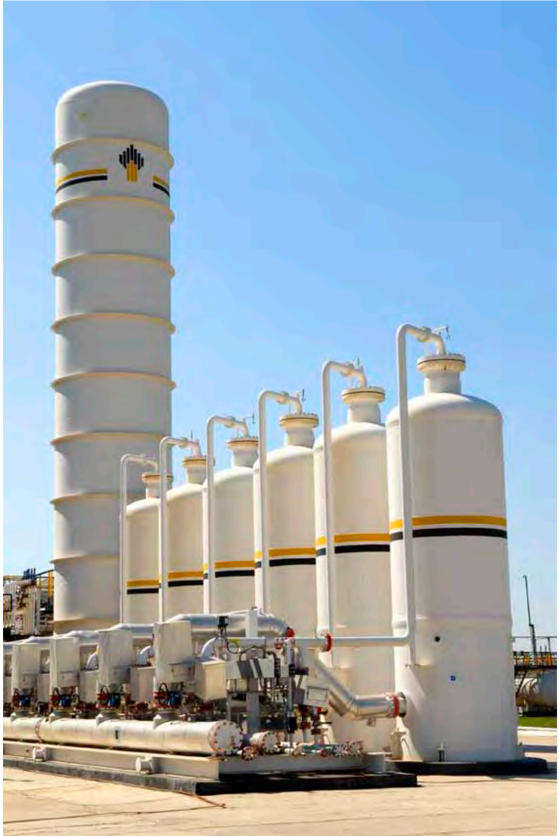
■ Новокуйбышевский НПЗ. Установка короткоцикловой адсорбции водород- содержащего газа
