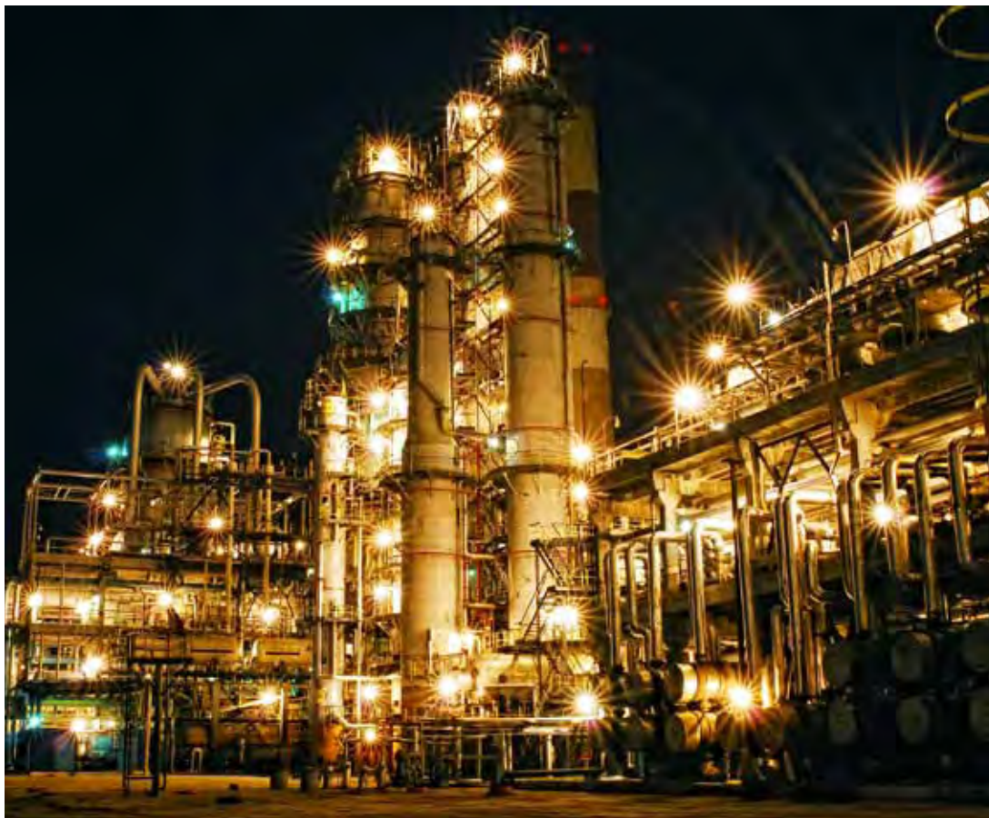
Установка ЭЛОУ-АВТ-6 на Сызранском НПЗ
